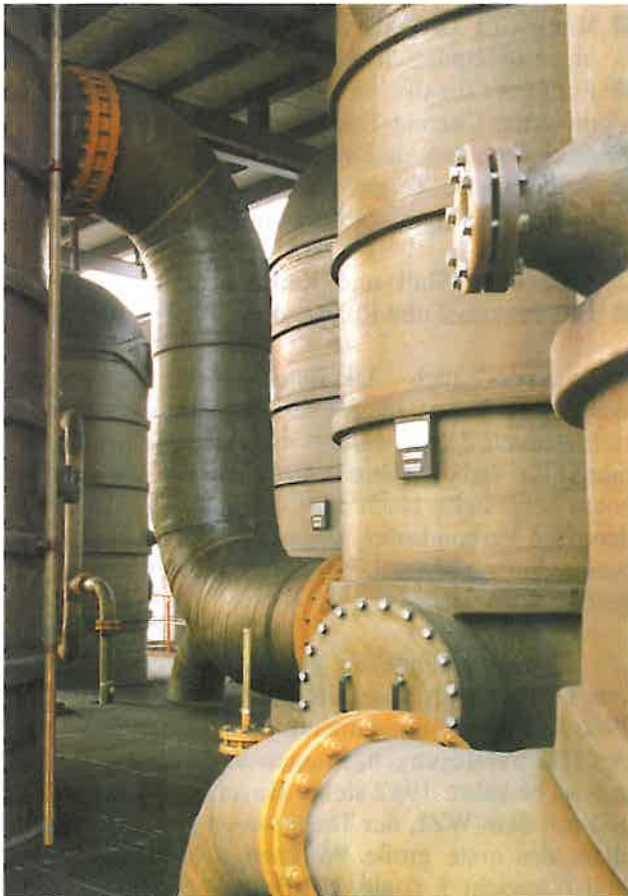
Abb. 7.2: Der Schwerpunkt der GF-UP-Anwendungen im Bauwesen liegt heute im Industrie- und Anlagenbau, hier einige Destillations-Kolonnen
