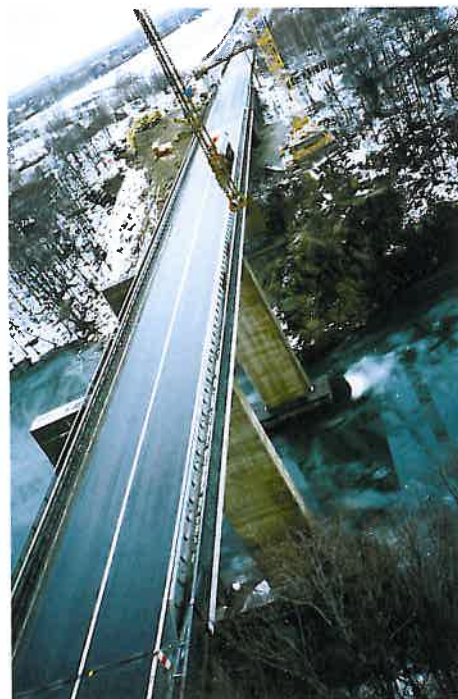
Abb. 1: Blick von Westen auf die vorhandene Stahlbrücke – im Hintergrund Beginn der Abbrucharbeiten auf der Nordseite
