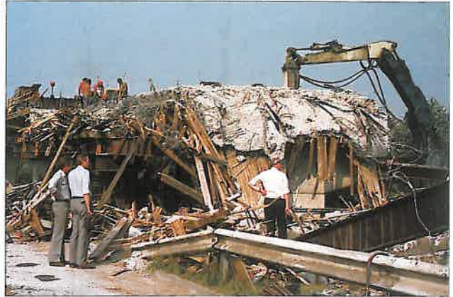
Abb. 35: Der Autor hatte als Sachverständiger diesen Einsturz eines Traggerüstes zu beurteilen
