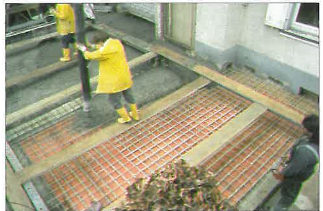
Abb. 8: GFK-Bewehrte Decke (System: Com-BAR)
