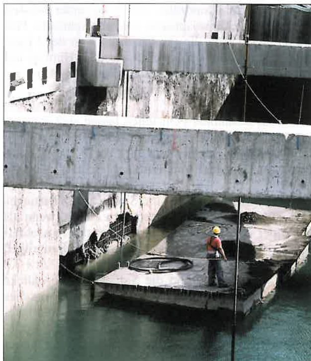
Abb. 6: Fehlstelle in einer Schlitzwandlamelle
