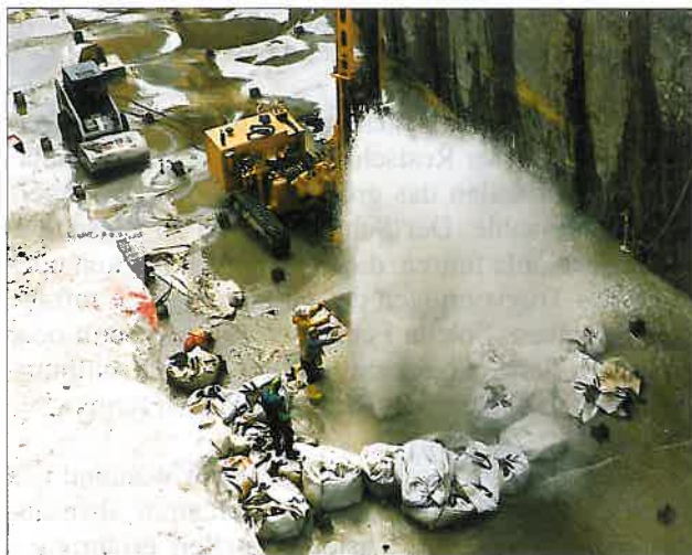
Abb. 7: Leckage einer UW-Betonsohle in der Nähe eines Pfahles
