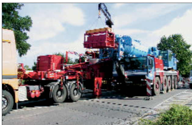
Abb. 15: Belastungssituation Hauptträger- und Querträger-test. Eine Fahrspur wurde während der Messung weiter befahren
