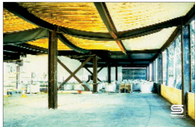
Abb. 7: Brandabschnitt nach dem Brand (Foto: British Steel)
