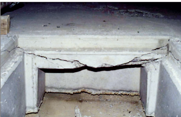
Abb. 8: Beim Anheben beschädigte Gleistragplatte in einem U-Bahntunnel
