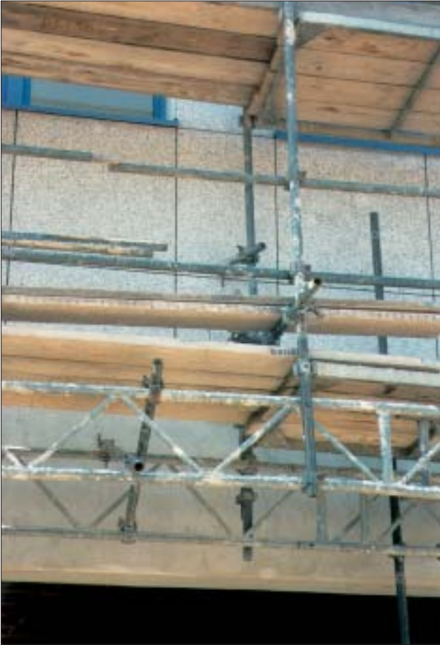
Anschluss nicht knotennah, Gurtbiegung
