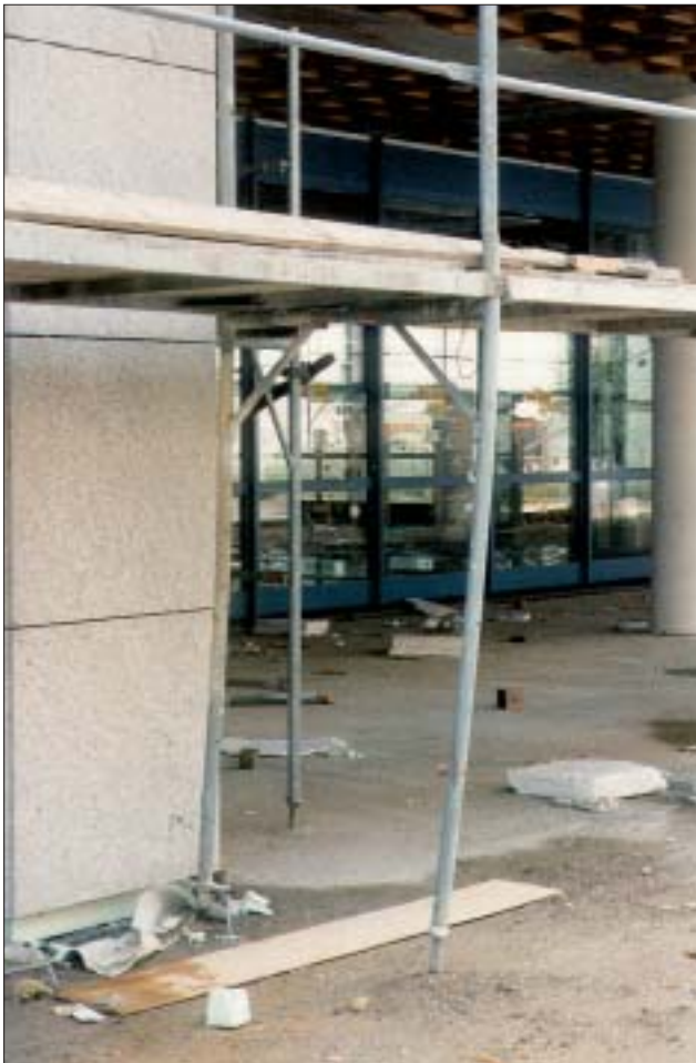
Stiel und Gründung nicht vor Anprall geschützt, fehlende Fußriegel
