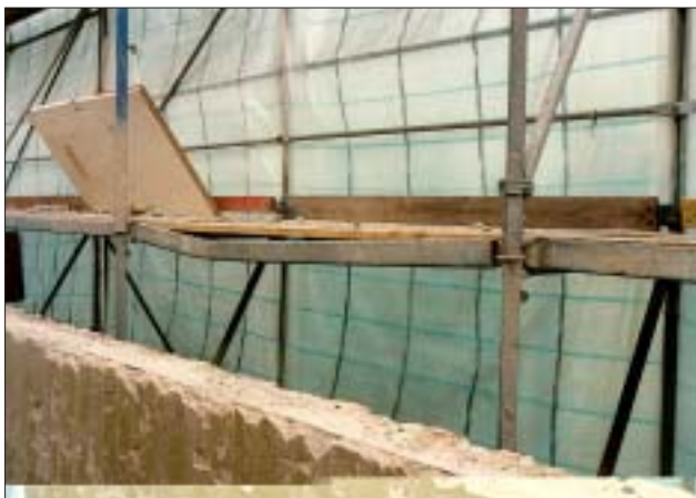
Verformter beschädigter Belagsrahmen
