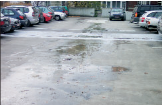
Abb. 1: Pfützenbildung auf einem Parkdeck durch ein nicht funktionsfähiges Entwässerungssystem
