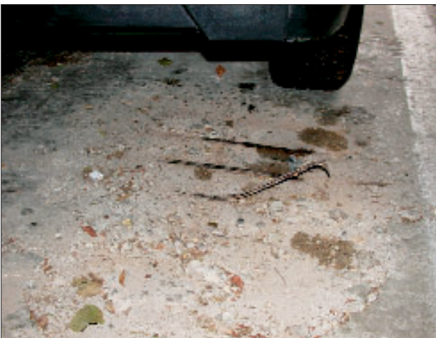
Abb. 2: Zerstörte Betonoberfläche mit herausstehender Bewehrung in einem befahrenen Bereich eines ca. 30 Jahre alten Parkhauses
