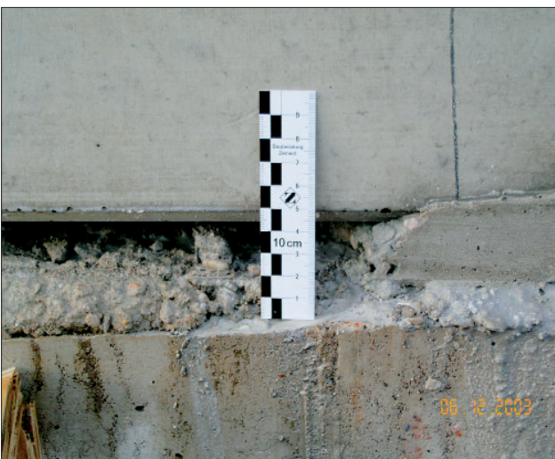
Abb. 6: Mangelhafte Untermörtelung führt zum Verlust von statischer Nutzhöhe
