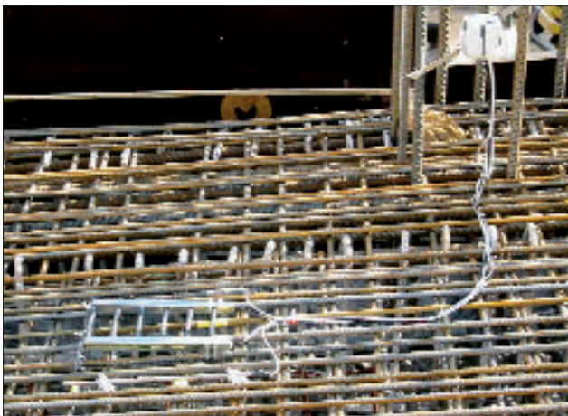
Abb. 4: Korrosionsüberwachungssystem mit leiterförmigen Sensoren und Messbox bei einem Parkhaus-Neubau
