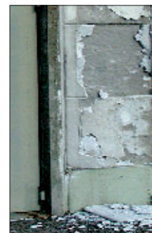
Abb. 1: Frostschäden an einer von Schlagregen beanspruchten Porenbetonwand mit diffusionshemmender Beschichtung.
