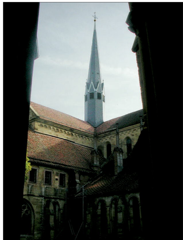
Abb. 18: Klosterkirche in Maulbronn: deutlich sichtbare Bewegungen der Turmkonstruktion während des Läutens
