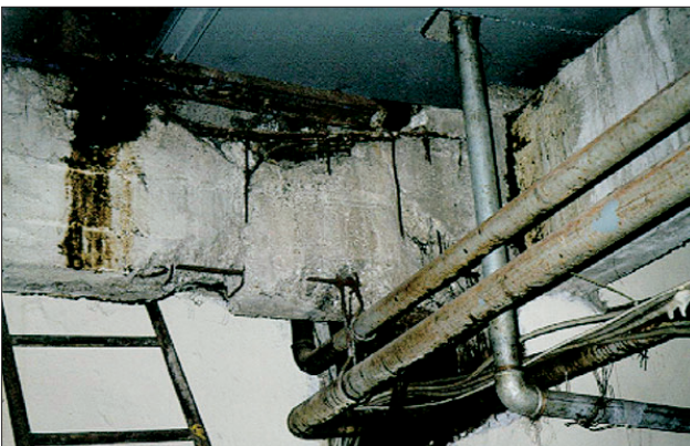
Abb. 4: Vorhandene Schäden im Verwaltungsgebäude
