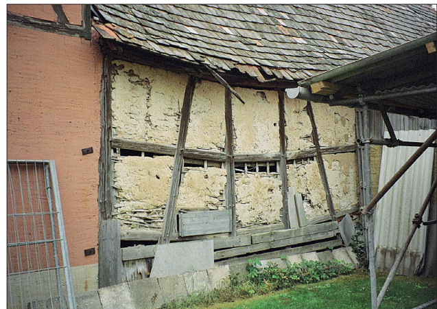
Abb. 28: Rohbauverformungen – so nicht !
