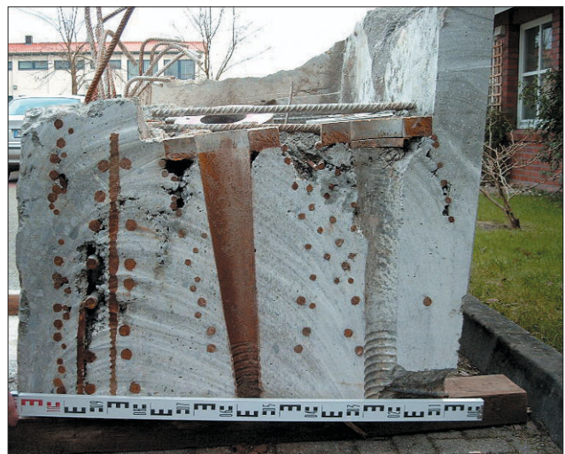
Abb. 1: Betonierfehler im Endquerträger
