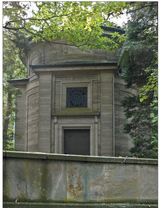
Abb. 27: Heutiger Zustand des Mausoleums der Familie Freytag oberhalb des Neustadter Stadtteils Hambach (Foto des Autors)
