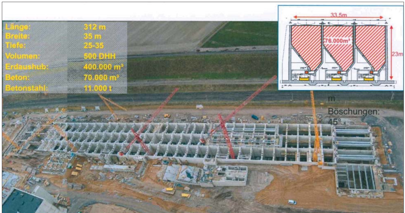
Abb. 4: Schlitzbunker des Kraftwerks Neurath (Gesamtbauzeit 2 Jahre)
