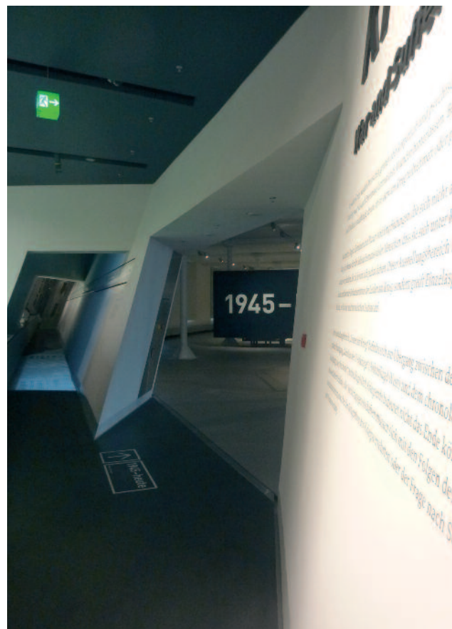
Abb. 14: Öffnung in der Keilwand mit Sprühflutanlage
