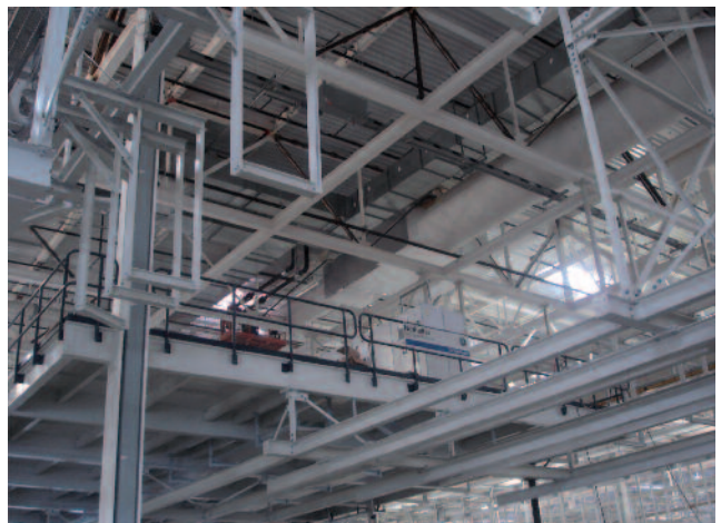
Abb. 4b: Schaltschrankbühne, darunter Sekundärstahlbau für EHB
