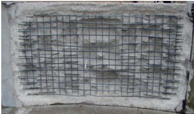
Abb. 7: Betonabplatzungen infolge EBA-Temperaturkurve bei herkömmlichem Beton (maximale Abplatztiefe ca. 250 mm)
