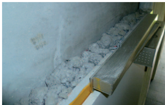
Abb. 3: Nicht fachgerechte Montage eines Feuerschutztürelements
