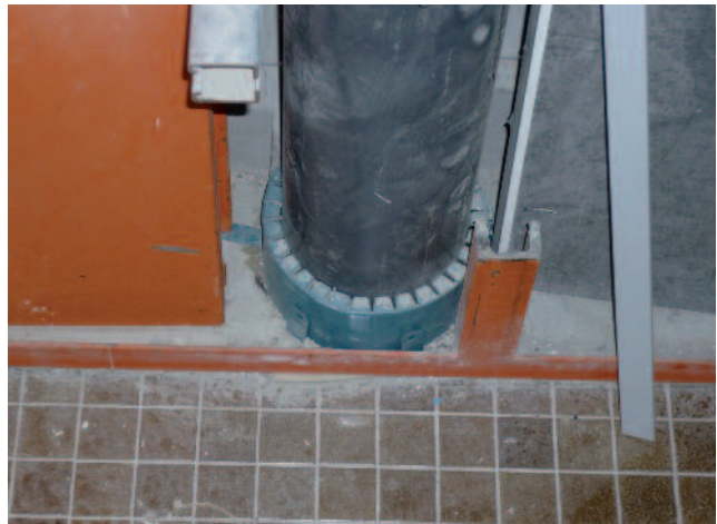
Abb. 5: Nicht fachgerechte Montage einer Brandschutzmanschette
