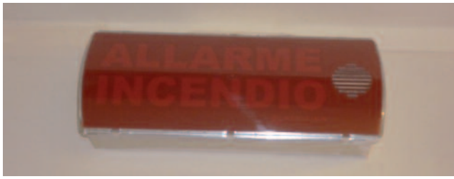
Abb. 6: Visuelle Brandalarmierung in einem Hotel
