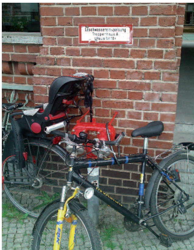
Abb. 2: Nicht benutzbare Löschwassereinspeisung
