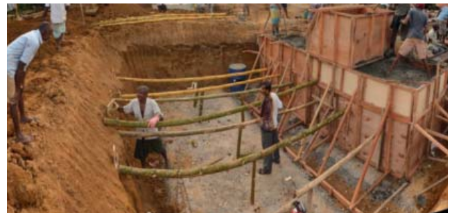
Abb. 8: MIT BAMBUSSTÄMMEN haben die Dorfbewohner den Studenten aus der Schalungsklemme geholfen, mit denen sie ihre Schalung verstärken konnten. Später haben sie dann einfach stabilere Kanthölzer benutzt.
